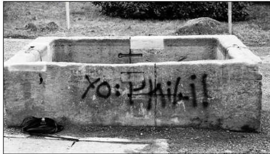
Historischer Sandsteinbrunnen auf dem Polzenberg mit Graffiti versehen
